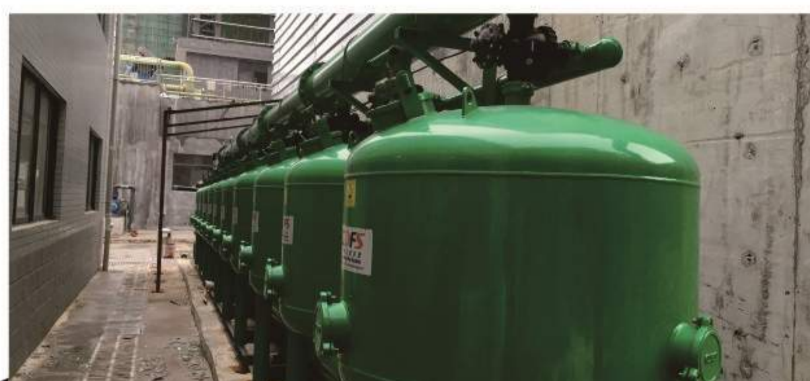
某垃圾发电厂循环水旁滤系统
