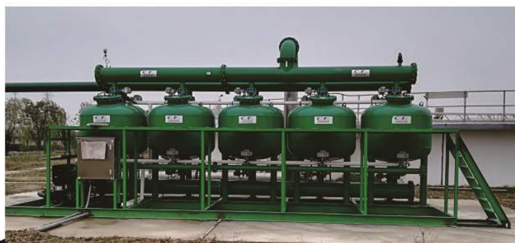
某污水处理厂中水回用系统
