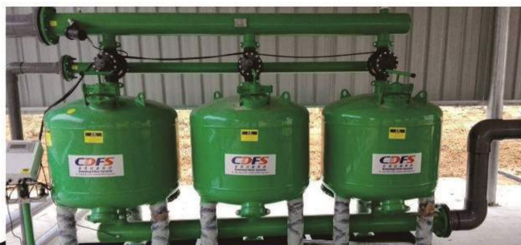
农业灌溉首部过滤系统
