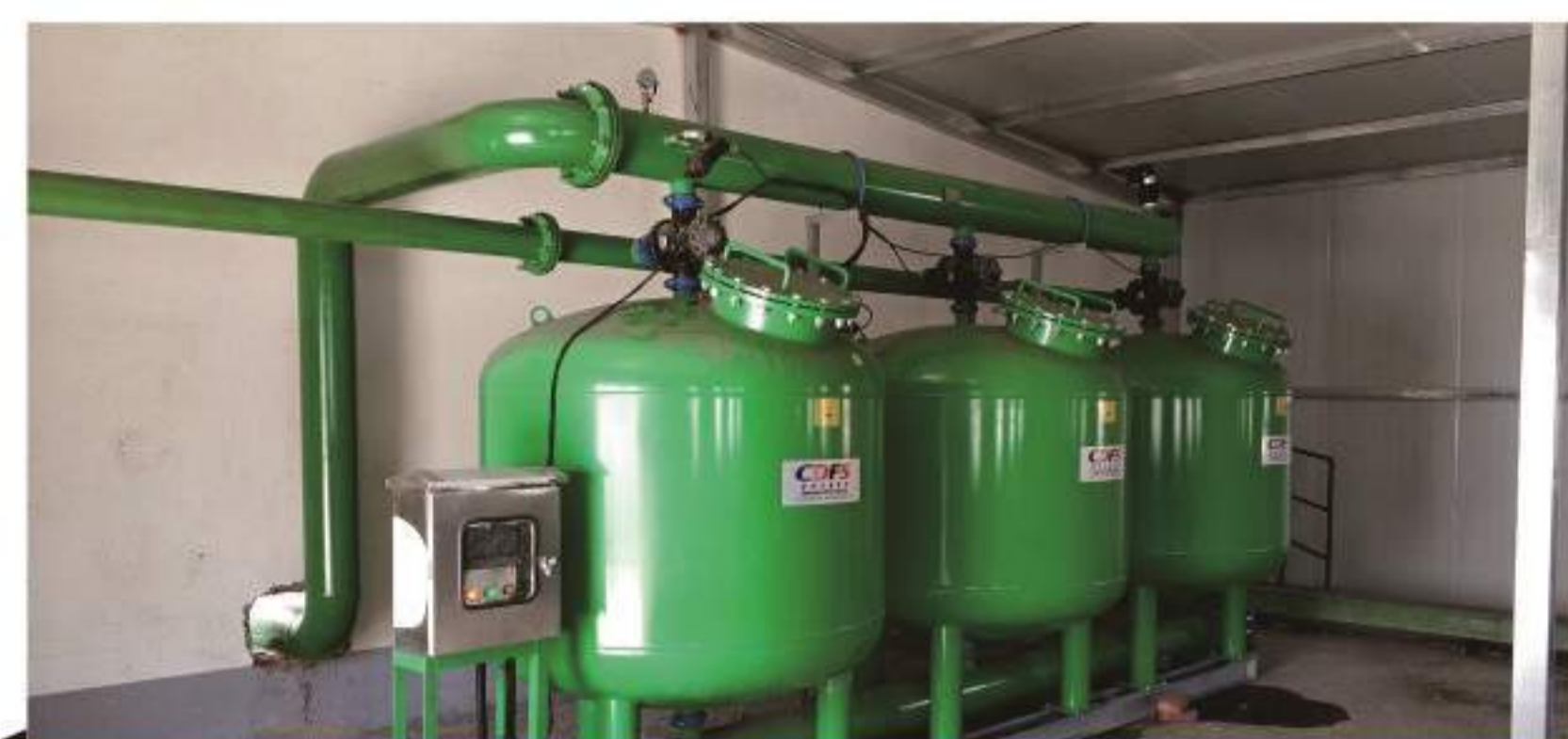
某集中式生活污水处理厂循环水旁滤系统
