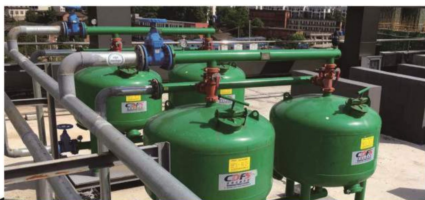
某数据中心冷却水过滤
