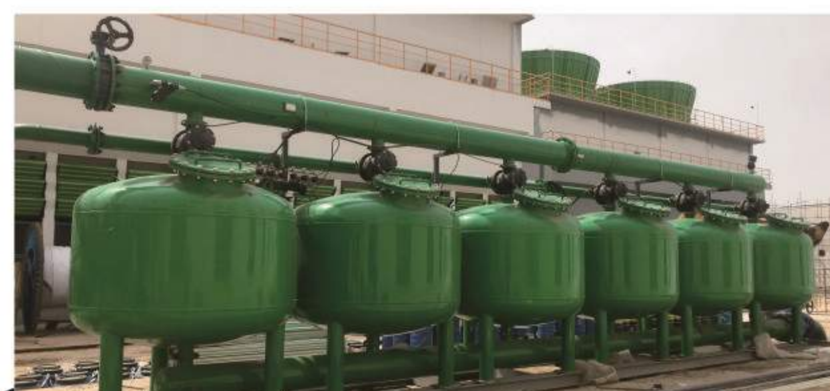
某焦化企业循环水旁滤系统
