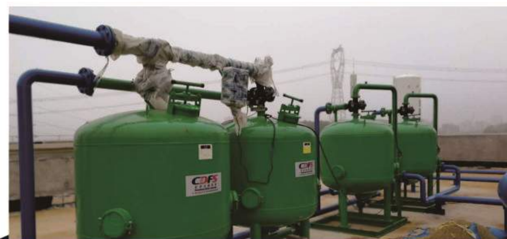
某新能源企业冷却循环水过滤
